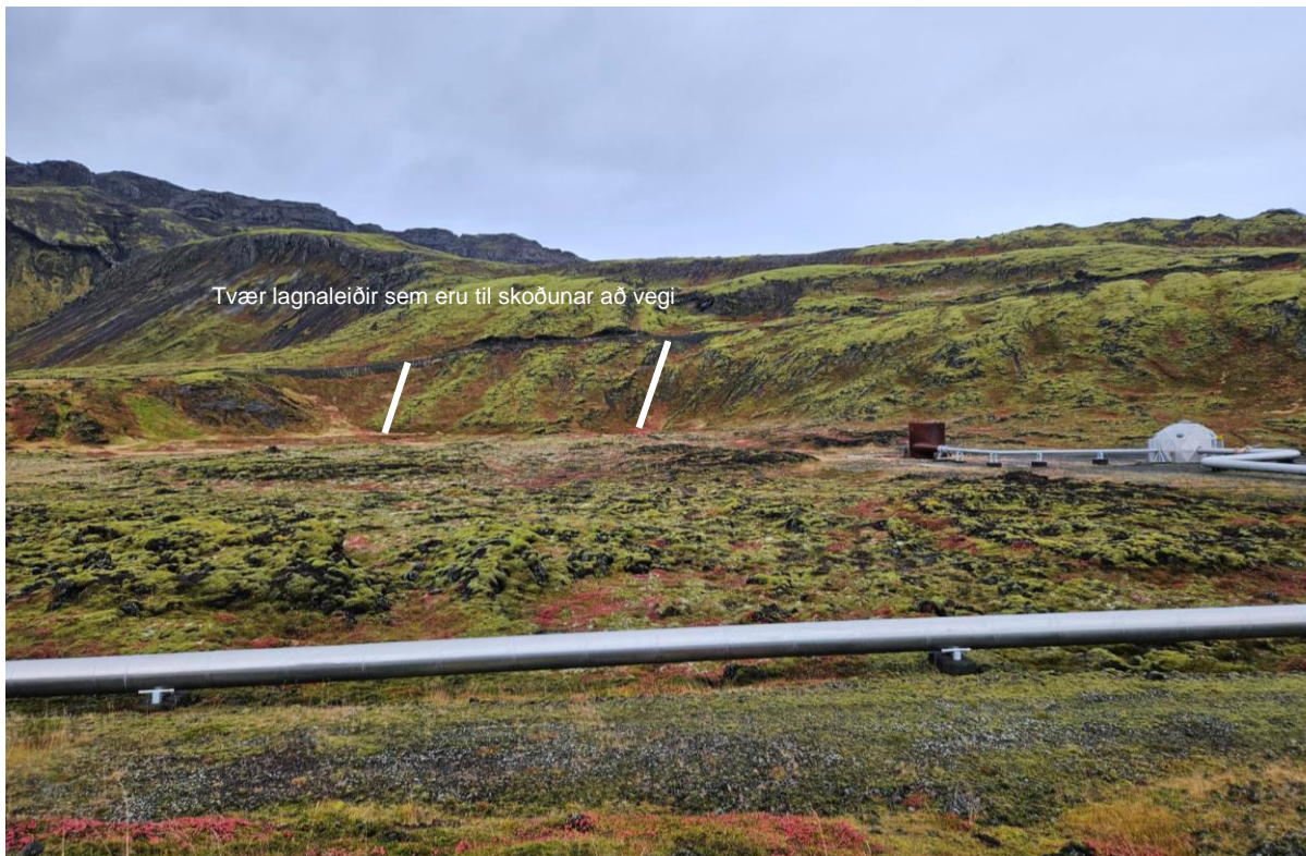
Mynd 5.9 Við eitt borsvæðið er til skoðunar tvær lagnaleiðir upp brekku að vegi sem liggur fyrir ofan borsvæðið. Tvær hvítar línur gefa til kynna staðsetningu þessara tveggja lagnaleiða. Mynd: Finnur Kristinsson.
