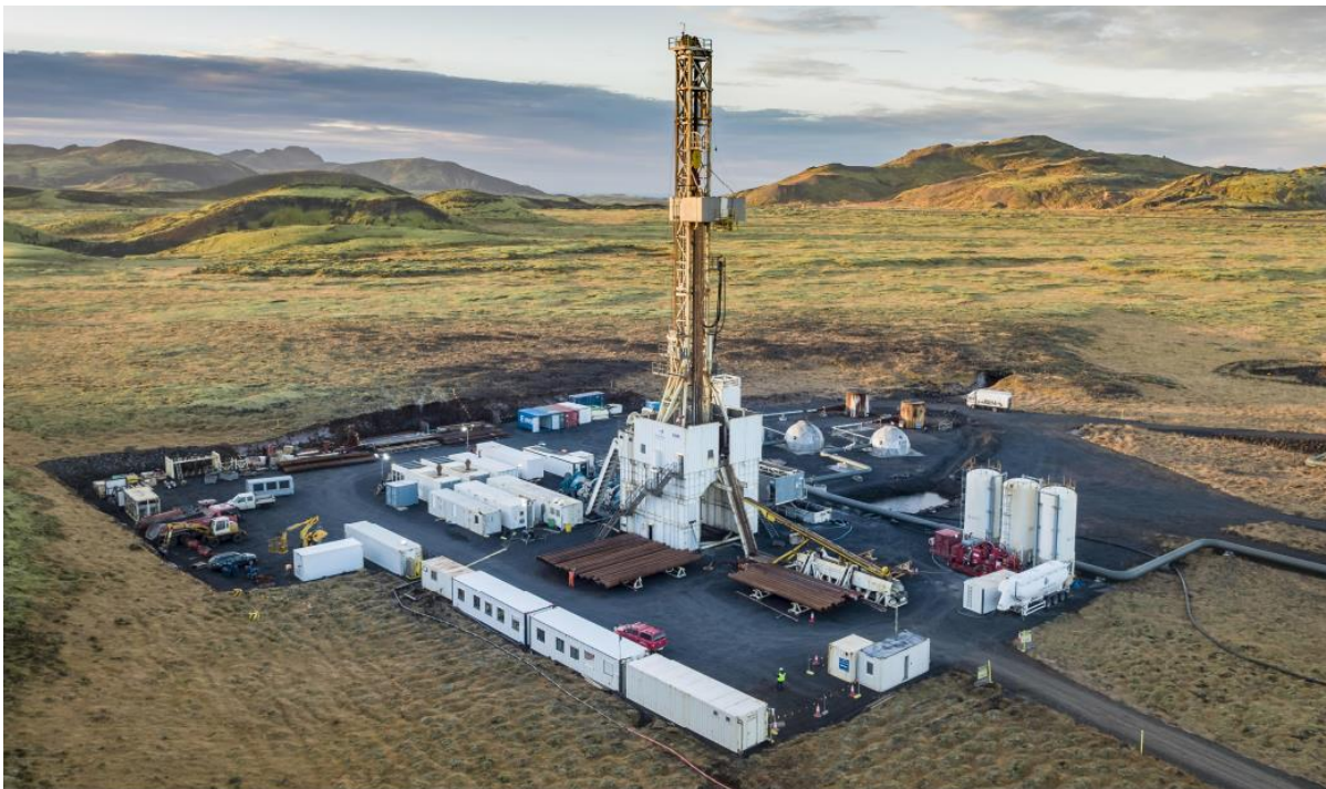
Mynd 4.2 Yfirlit yfir borplan þar sem verið er að bora viðbótarholu. Fyrir eru 2 borholur á borplaninu. Borinn er fyrir miðri mynd. Hægra megin við borinn má sjá svarþró á milli kúluhúsa og silóa. Á milli svarþróar og bors er dælukar. Sílóin geyma þurrefni í steypuna. Framan við borinn má sjá brún rör sem eru borstangir notaðar við borunina. Mynd frá Jarðborunum hf. (Verkís, 2020).
